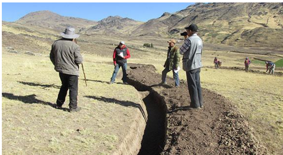
Zanjas de infiltración en Huancavelica Perú.
